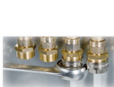
Collegare le tubazioni. Fare un lavaggio ed effettuare la prova in pressione.
